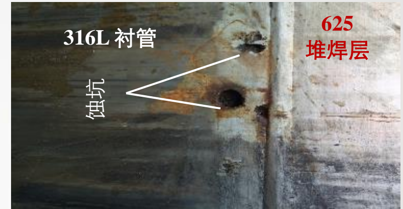
双金属复合海管失效实物图
